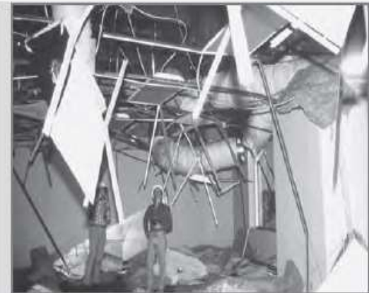
تخریب کامل سقف کاذب و چراغ های سقفی در اثر زلزله
