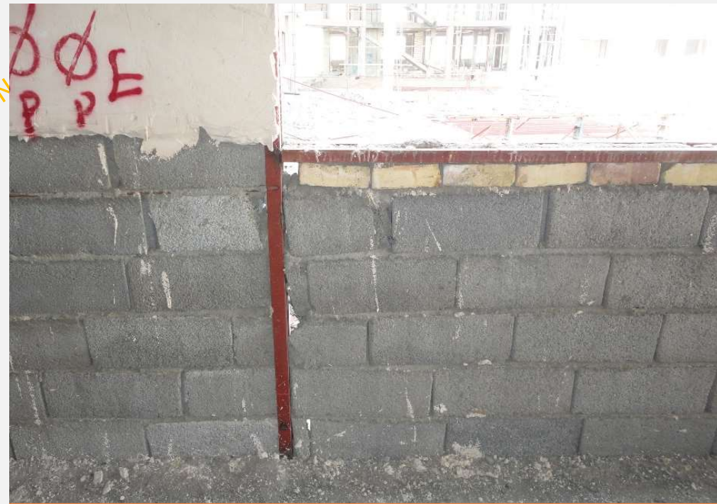
عدم اجرای صحیح مهار دیوار در جهت خارج صفحه در پایین پنجره
