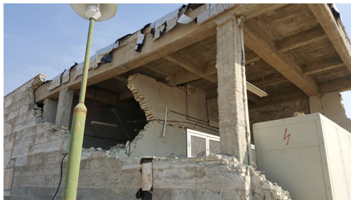
تخریب دیوار محیطی در اتاق برق
