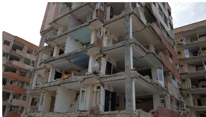
تخریب دیوارهای محیطی به دلیل عدم اجرای وال پست و نمای سنگین آجری
