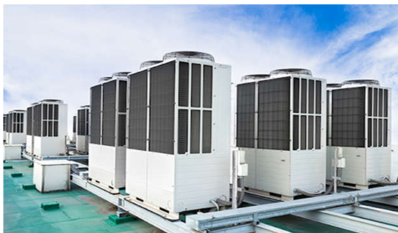
شکل ۱-۳۹: نمایی از سیستم‌های VRF نصب شده روی پشت بام [43].
